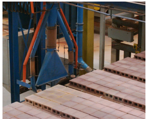
Abb. 19 Reinigung von Tunnelofenwagen mit beweglichen, speziell angepassten Erfassungseinrichtungen
