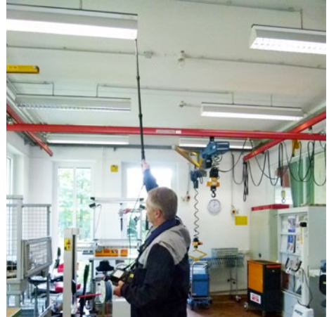
Abb. 9 Messung der niederohmigen Schutzleiterverbindung; Leuchte
