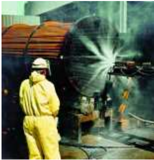
Abb. 3-5: Röhrenbündelwärmetauscher, Reinigungsgerät. Für wiederkehrende Arbeiten sollten automatisierte Lösungen gesucht werden: dies ist die effektivste Maßnahme zur Minimierung der Gefährdung.
