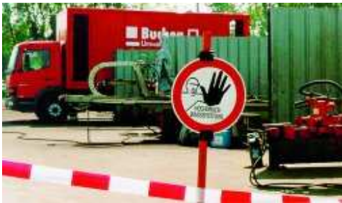
Abb. 3-10: Da die Gefährdung für Unbeteiligte nicht ohne weiteres ersichtlich ist: Bereich kennzeichnen und absperren.
