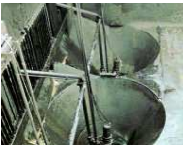
Abb. 5-1: Absetztrichter in Vorklärbecken
