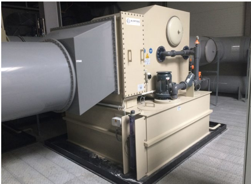
Abb. 9.1 Wiederkehrende Instandhaltung am Nasswäscher einer Abluftanlage
