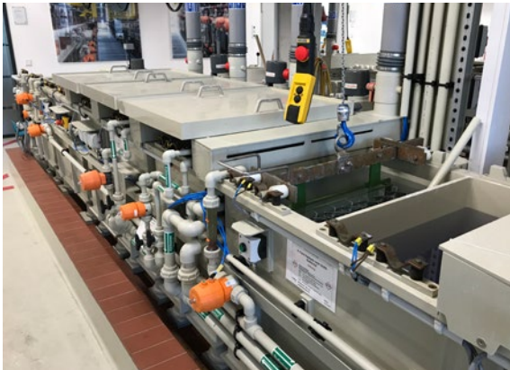
Abb. 4.2 Abgedeckte Prozessbehälter mit Randabsaugung
