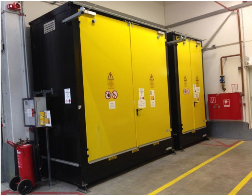
Abb. 8.2 Sicherheitsschrank zum Lagern von Gefahrstoffen
