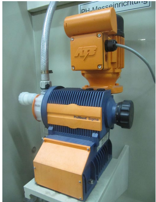
Abb. 10.1 Dosierpumpe als technische Schutzmaßnahme gegen chemische Gefährdungen bei Tätigkeiten der Beschäftigten an den Elektrolyten und Prozessbehältern
