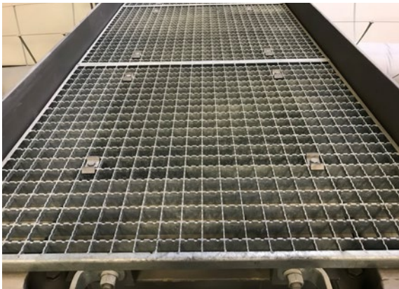
Abb. 2.3 Sicher befestigte Bodenroste
