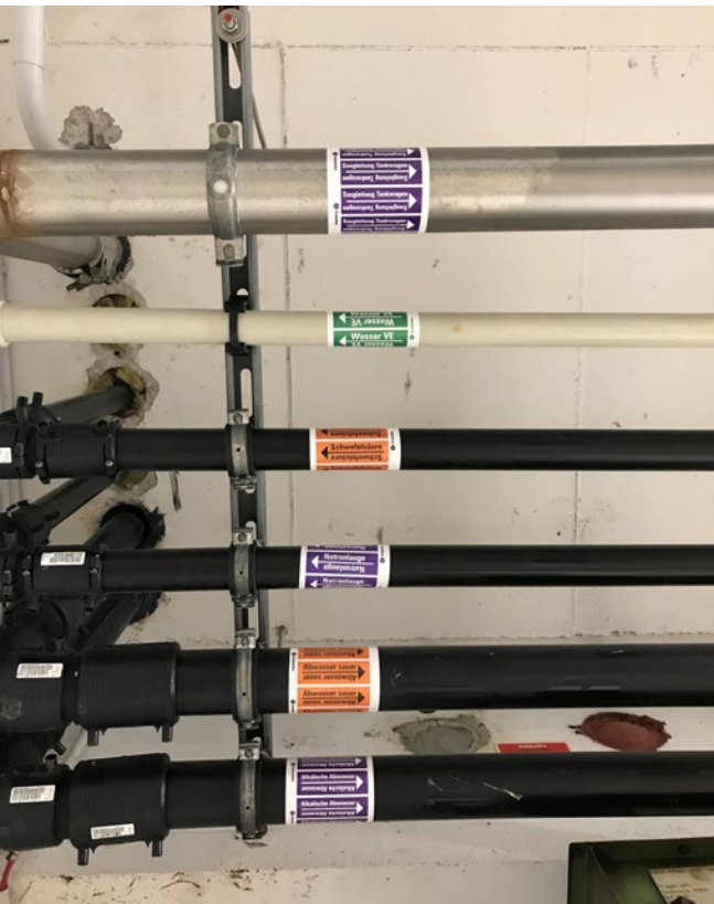
Abb. 2.5 Kennzeichnung von Rohrleitungen nach TRGS 201
