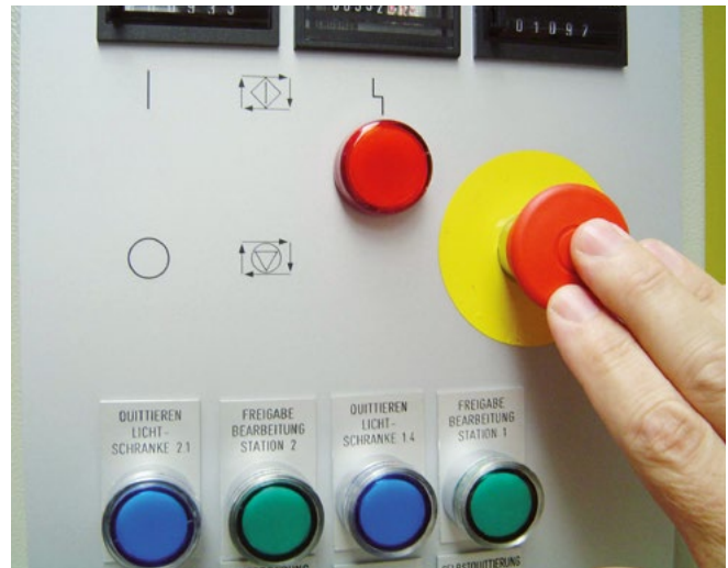
Abb. 32 Not-Halt-Befehlsgerät an einer Roboteranlage [H]
