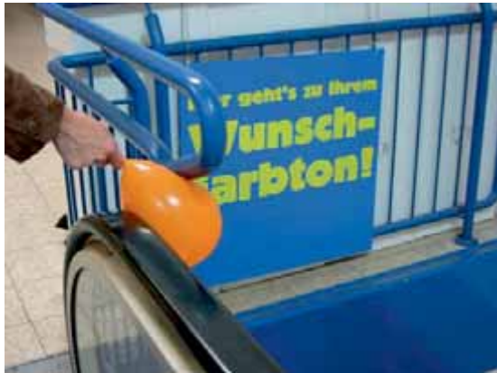
Bild 4: Einzugsgefahr am erhöhten Geländer
