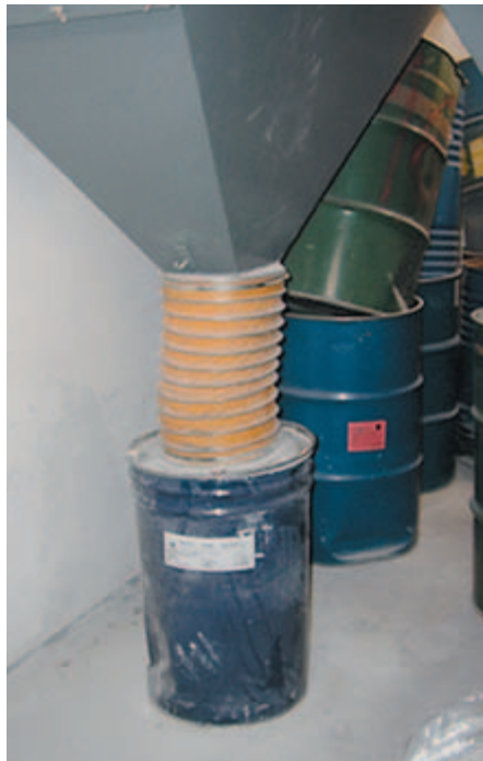
Bild 5-17: Filterauslass in einer Buntmetallgießerei
