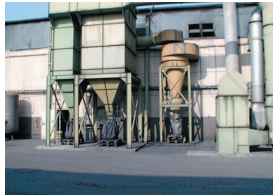
Bild 3-4: Filteranlage einer Buntmetallgießerei
